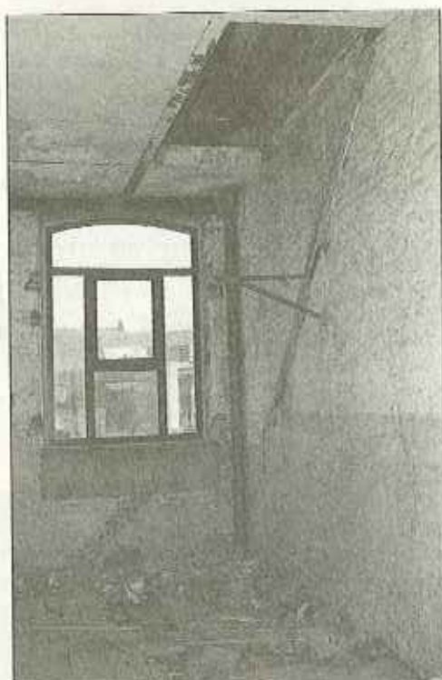
Espace Mélayers - 1 er étage D'importants travaux de remise en état doivent être réalisés.
