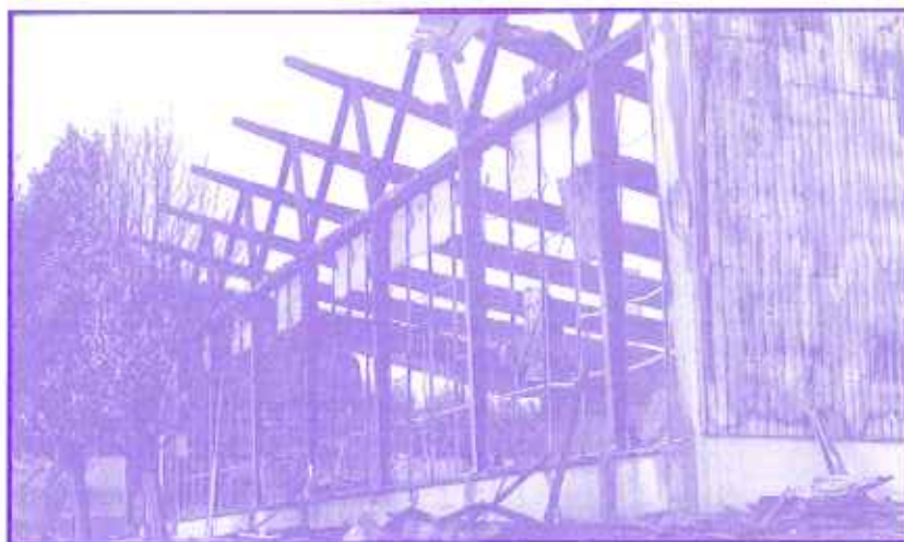
INCENDIE à LA SALLE LÉO LAGRANGE
